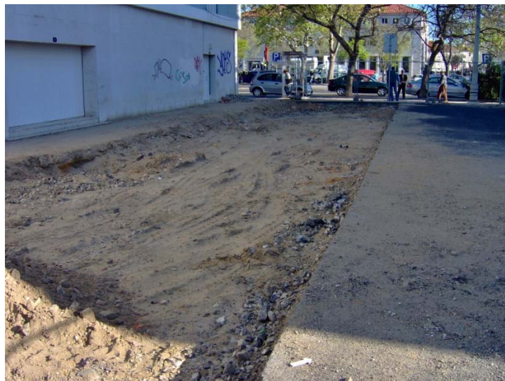
Figura 2 – Vista para a Avenida Luís Todi. Fonte: Intervenção arqueológica de 2008. Fonte: dos autores.
